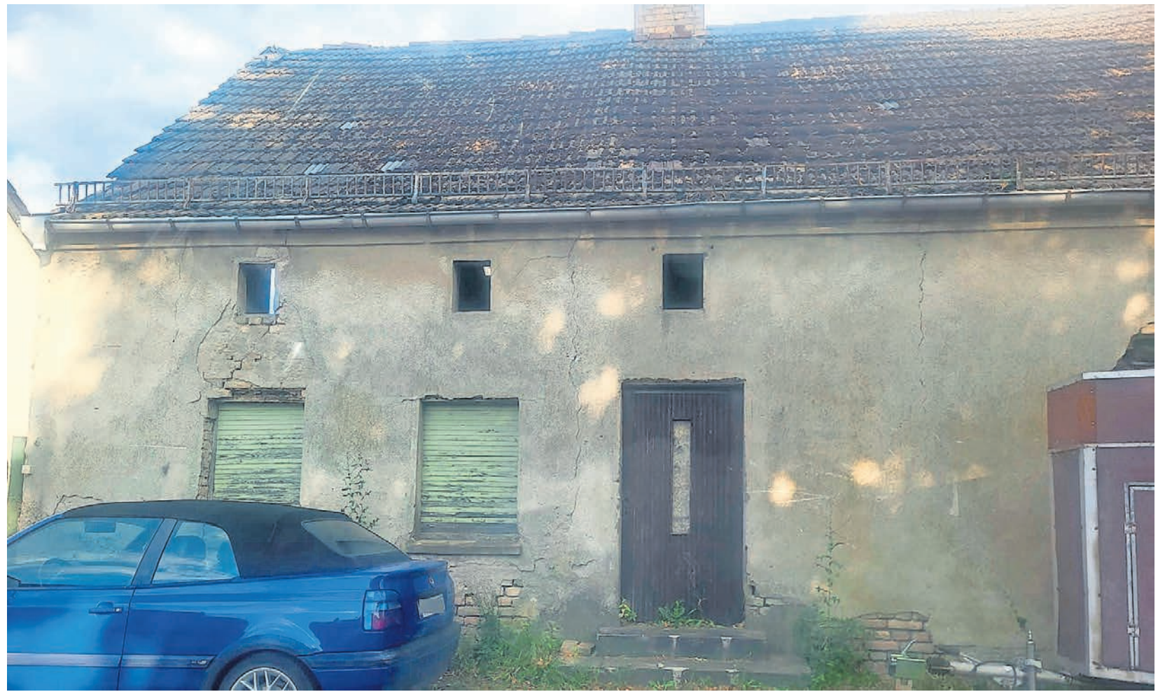
Unter der Anschrift eines abbruchreifen Hauses in Schönefeld (Nuthe-Urstromtal) firmieren zahlreiche Firmen von Bartłomiej S.
